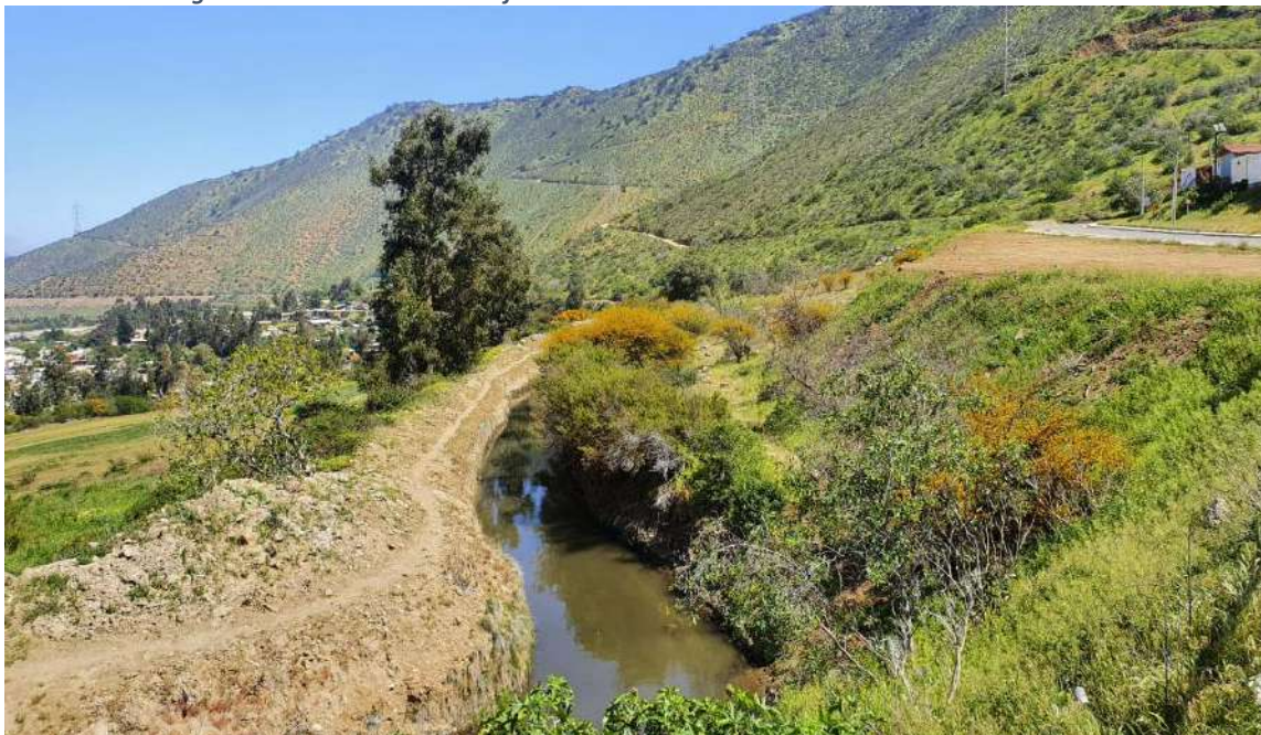
Imagen 22: Canal. Se observa la falta de elementos de contención ante eventuales crecidas
